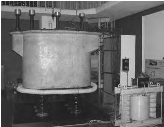
Rys. 8. Transformator TPZ 160 kV 300 kVA przerobiony z niemieckiego transformatora 200 kV z TH Breslau, wykorzystywany w latach 1962-2014 [5]
